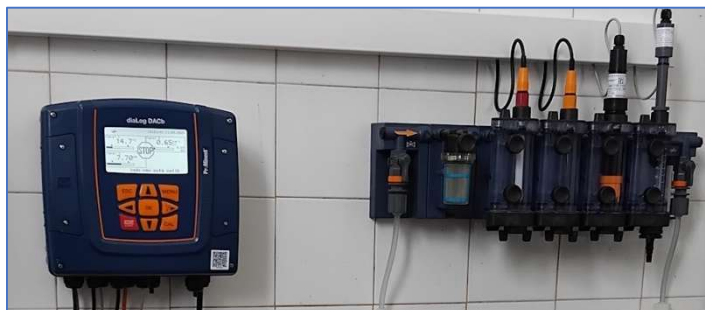
Imagem 36: Sistema de monitorização de cloro residual e pH do ponto de recloração do Vilar dos Prazeres
