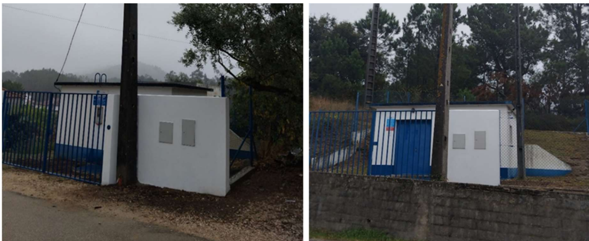
Imagem 47: Execução de muretes técnicos de Cardeais (à esq.) e Fartaria (à dir.)
